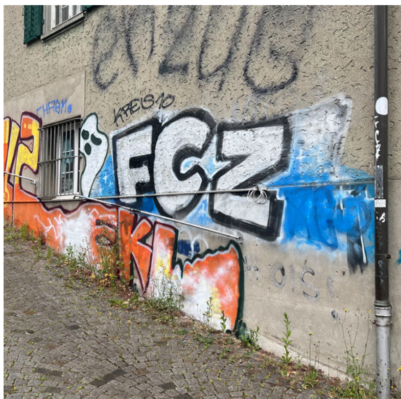
Beispiel einer völlig verschmierten Hauswand mitten in Höngg. (Foto: jao)
