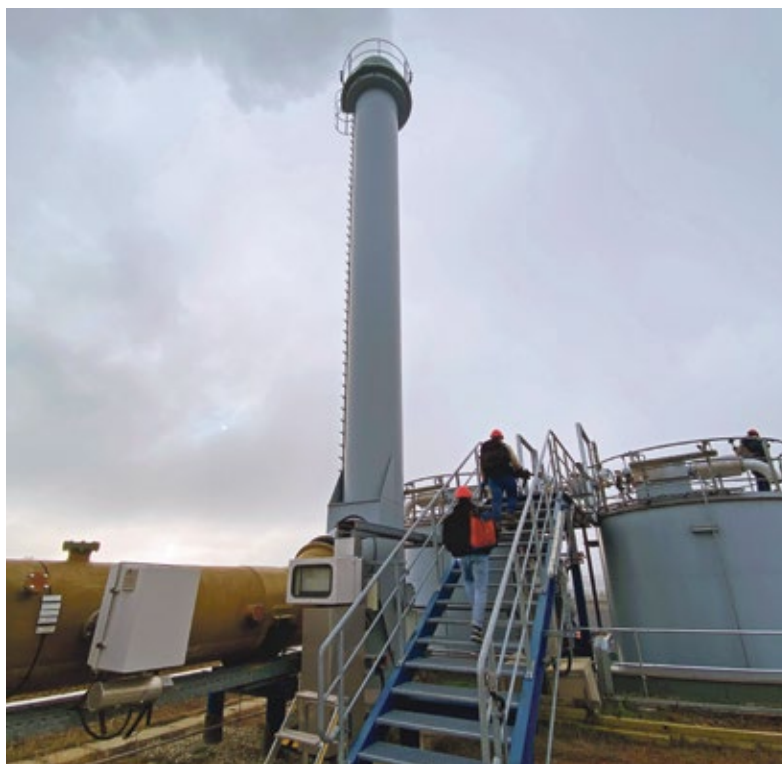
Ab 2028 sollen rund 90 Prozent des aus diesem Kamin austretenden CO 2 abgeschieden werden.
