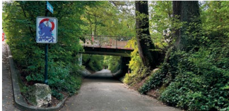
Die Brücke bei der Segantinistrasse über die Holbrigstrasse wird saniert. (Foto: dad)
