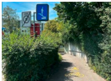
In dieser Fussgängerunterführung bei der Frankentalerstrasse wurden Schmierereien entdeckt. (Foto: zvg)
