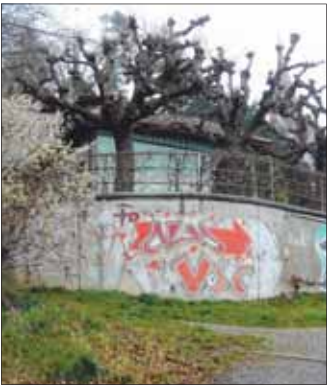
Graffito: Stützmauer alter Friedhof, oberhalb Rebberg.
